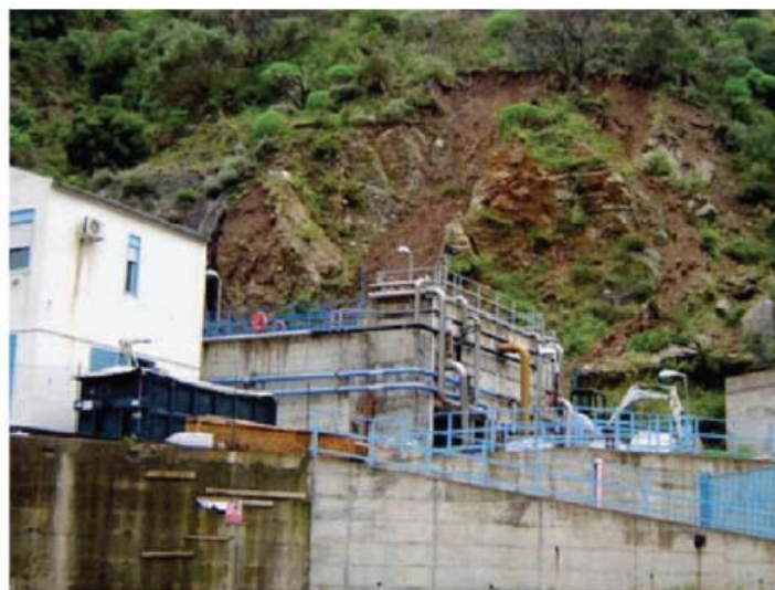
LA FRANA CHE INCOMBE SULL'IMPIANTO DI DEPURAZIONE CONSORTILE DI CONTRADA S. FILIPPO
